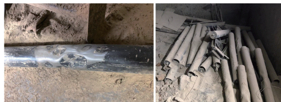
(b) 托辊变形 (b) Roller deformation
