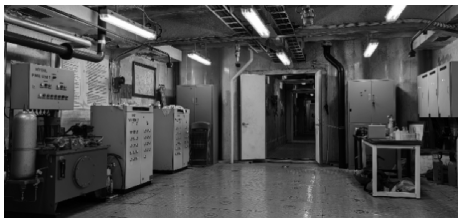
图 7 室内实测环境 Fig. 7 Practical environment
