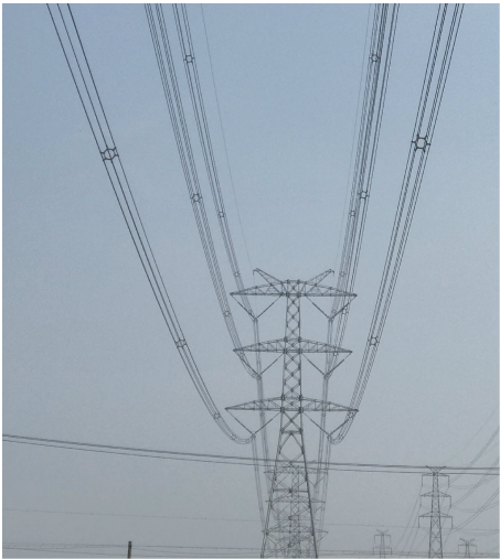
图 6 实际输电线路
