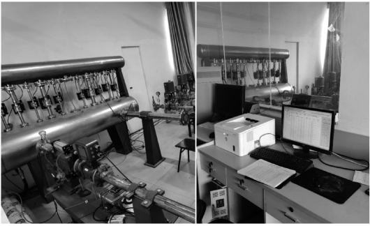
图 4 临界流文丘利喷嘴法气体流量标准装置
