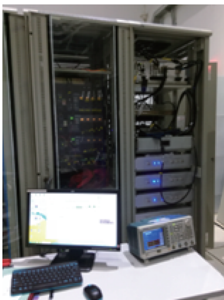
图9 离子源厅发射度控制读出设备现场
